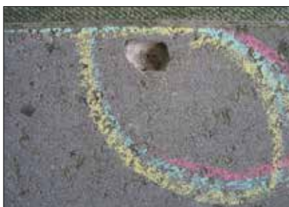
Et hul i overfladen som følge af porøst korn i tilslaget, opstår normalt inden for det første år.
