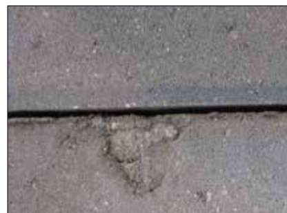
Øverst ses revner i overfladen som følge af fejl i støbningen eller håndteringen. Nedenunder et eksempel på mangelfuld fyldning af formen, der har givet en fordybning i kanten af flisen, skal sorteres fra før lægningen.
